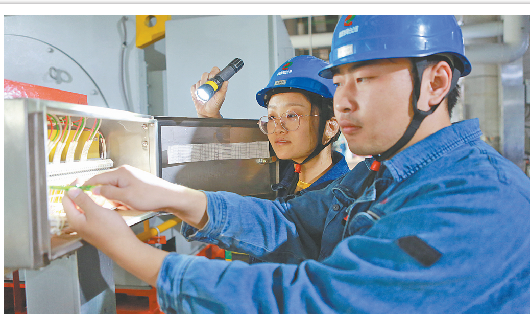
双节期间,国家电投沁阳发电分公司广大职工坚守岗位,精心检修维护发电设备,确保工业生产生活和居民生活用电。图为该公司职工正在对热控装置进行检修维护。
