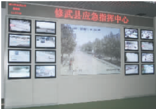
高科技的数字化监控平台
