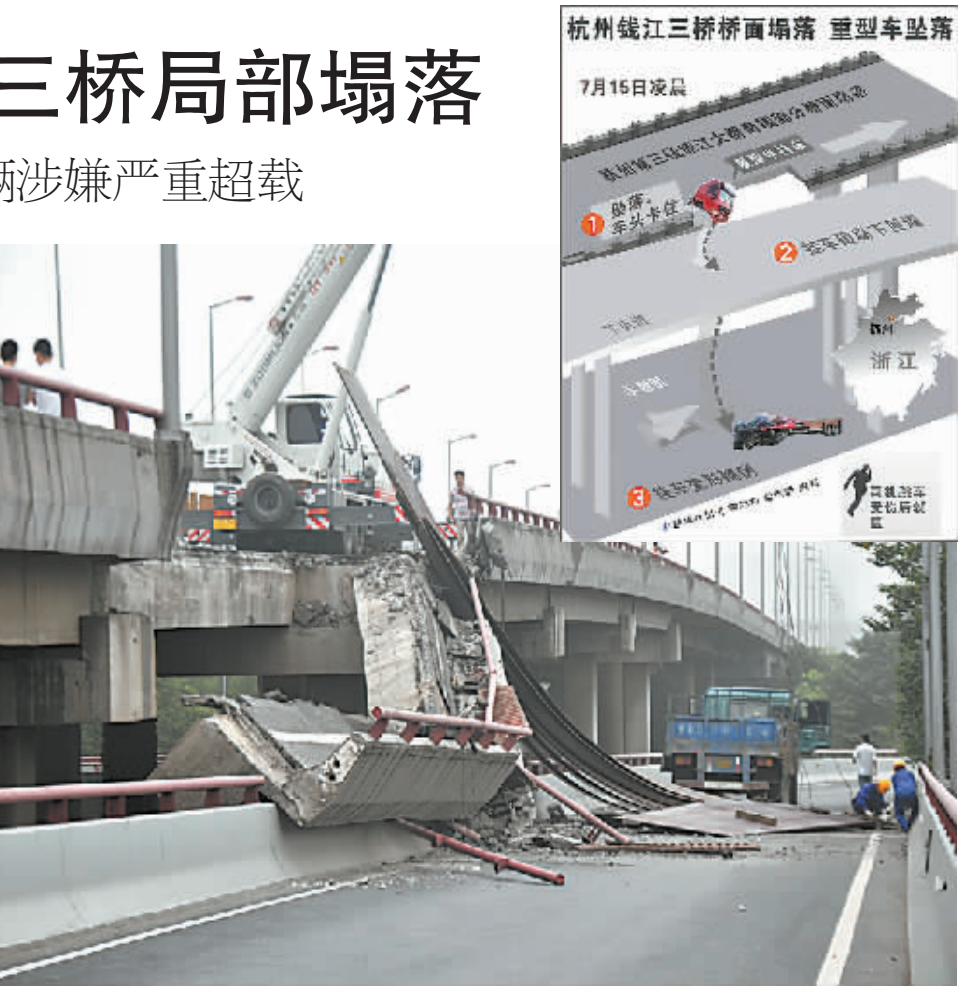
图为钱江三桥部分桥面塌落现场。
