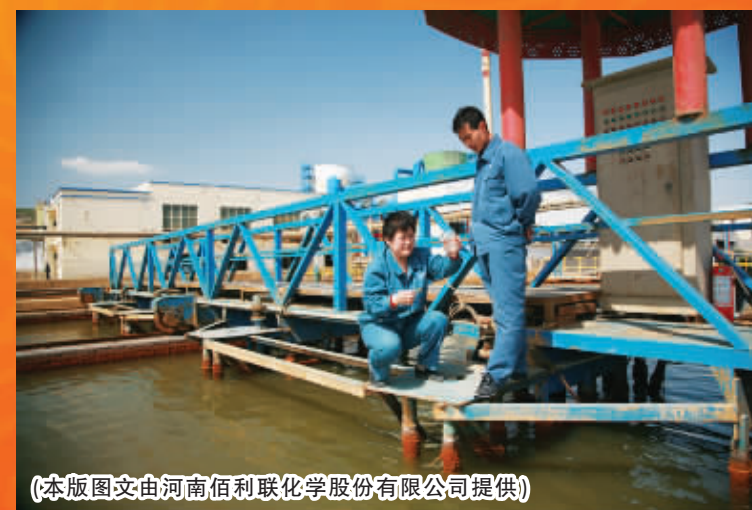
公司水处理分公司沉淀池一角
