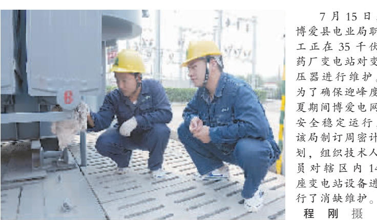
7 月 15 日,博爱县电业局职工正在 35 千伏药厂变电站对变压器进行维护。为了确保迎峰度夏期间博爱电网安全稳定运行,该局制订周密计划,组织技术人员对辖区内 14 座变电站设备进行了消缺维护。
