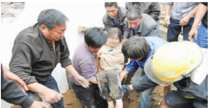
近日，温县番田镇一居民家老房顶坍塌，两名居民被埋在废墟里，温县公安局党委副书记李世軒接警后，带领民警和消防官兵及时赶到现场展开救援工作。目前，两名伤者已脱离危险。图为李世軒（左二）与群众一起将废墟下的王某救出。张建设 张 志 摄
