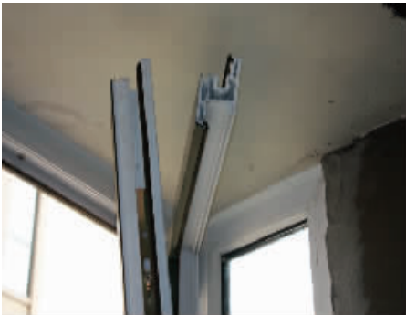
新房的窗框是断裂的。
