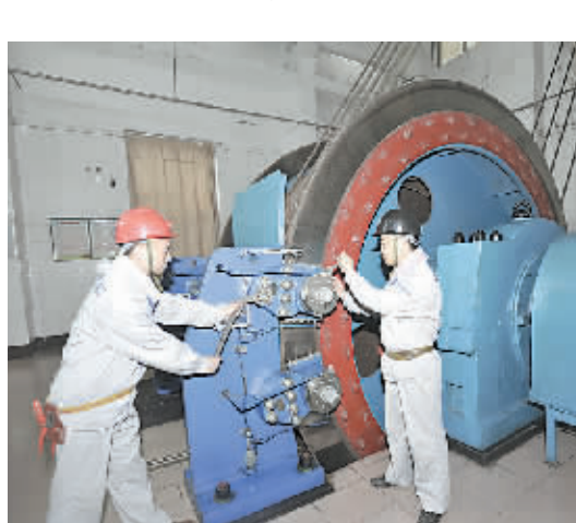
在第十一个“安全生产月”活动到来之际,河南煤业焦煤集团古汉山矿工会积极开展“查隐患、保安全、我为企业作贡献”活动,促进了安全生产工作的有效开展。图为该矿绞车房维护工在对机电设备进行安全隐患排查。许凯 摄
