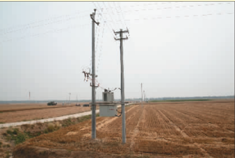
黄河滩区土地开发整理项目架设的供电线路。
