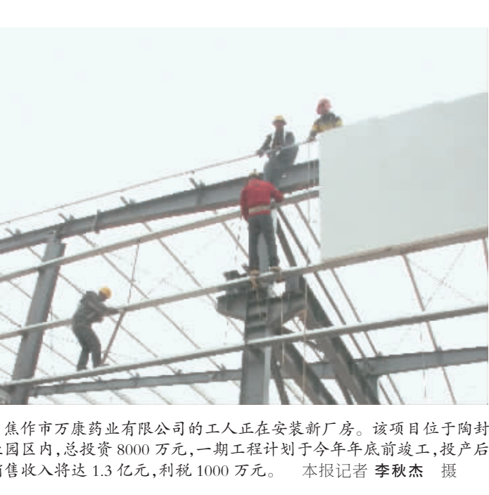
焦作市万康药业有限公司的工人正在安装新厂房。该项目位于陶村工业园区内,总投资8000万元...
