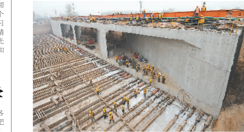
昨日9时许,记者在市人民路延伸工程下穿新月铁路立交桥项目施工现场看到,东边单侧重达1.3万吨的框架箱体向南顶进了26米,到达新月铁路正下方。据悉,该工程自今年10月9日开始架空修路,10月21日开始顶进,经过施工人员一个月的努力,昨日终于将单侧框架箱体顶进成功。
