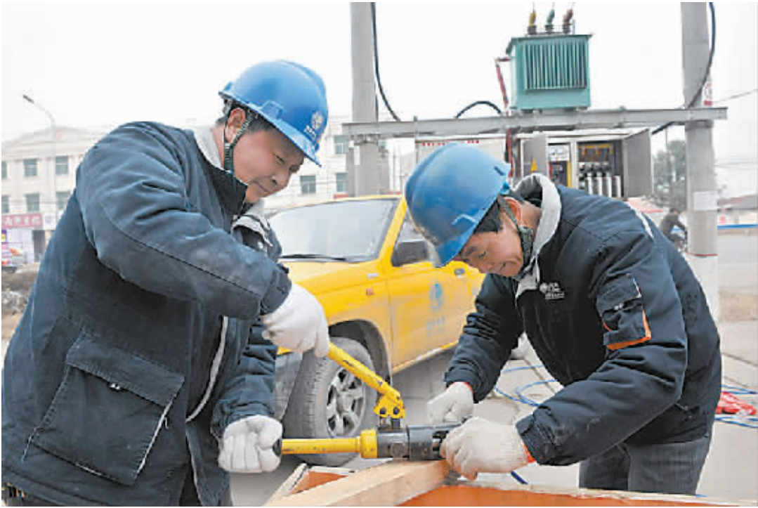
连日来,孟州电力公司组织38名农电工深入该南400伏台区供电设施。本报记者 杨帆 本报通讯员 聂小品 摄
