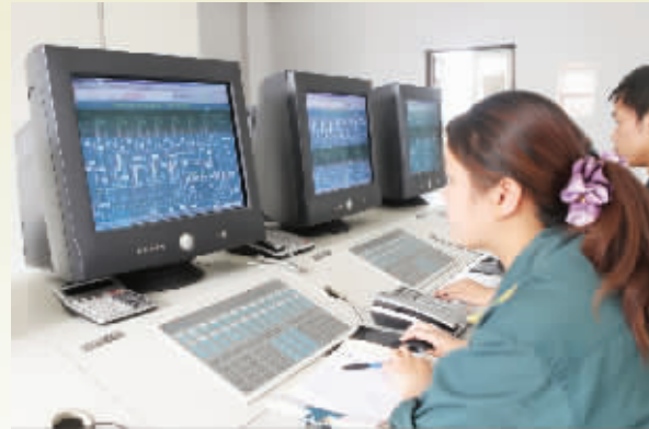
自动化监控室
