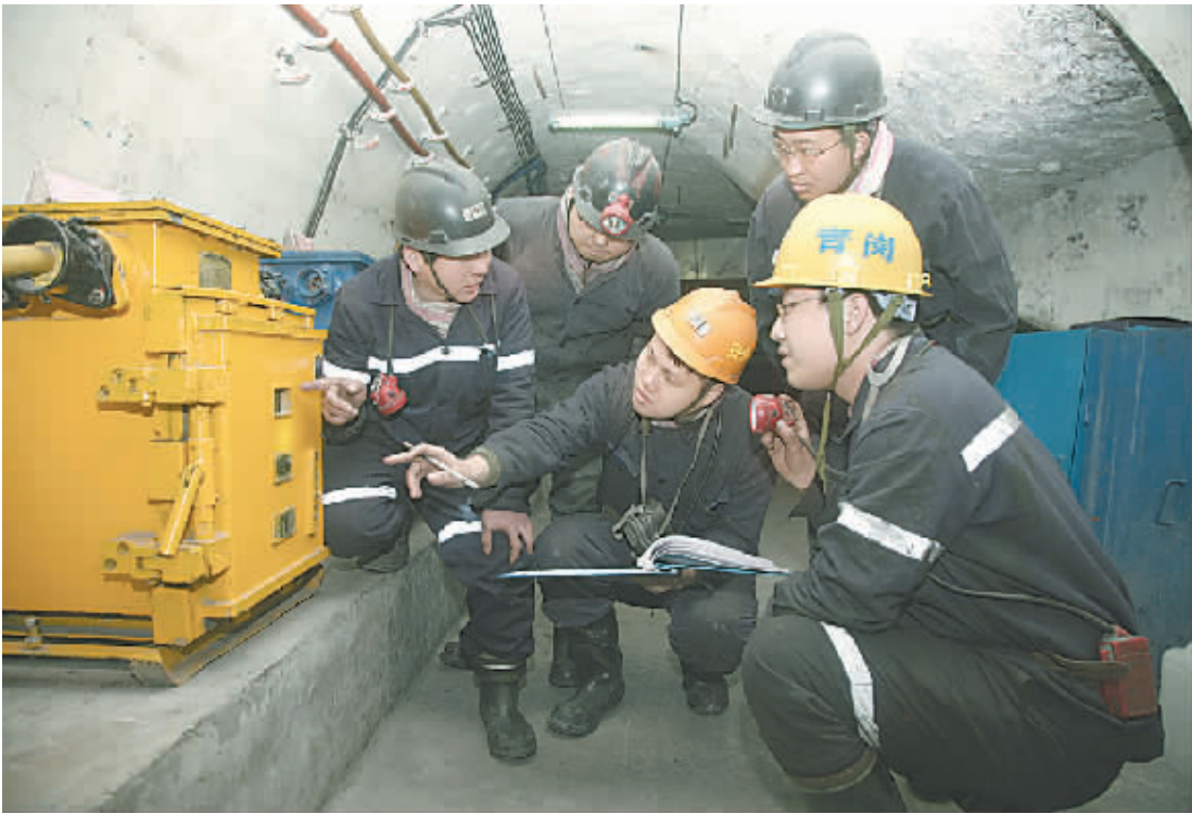
5月2日,赵周二矿安全联查小分队在猴车硐室检查设备运转及防爆情况。连日来,该矿安全联查小分队围绕瓦斯治理、机电安全等重点工作,在井上、井下进行了隐患大排查,切实做到隐患排查无死角、解决问题不拖延,确保矿井的安全生产。
