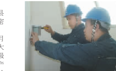
温县供电公司城镇供电所城区“电力片警”服务队队员正在工作。 本报记者 张 璐 摄
