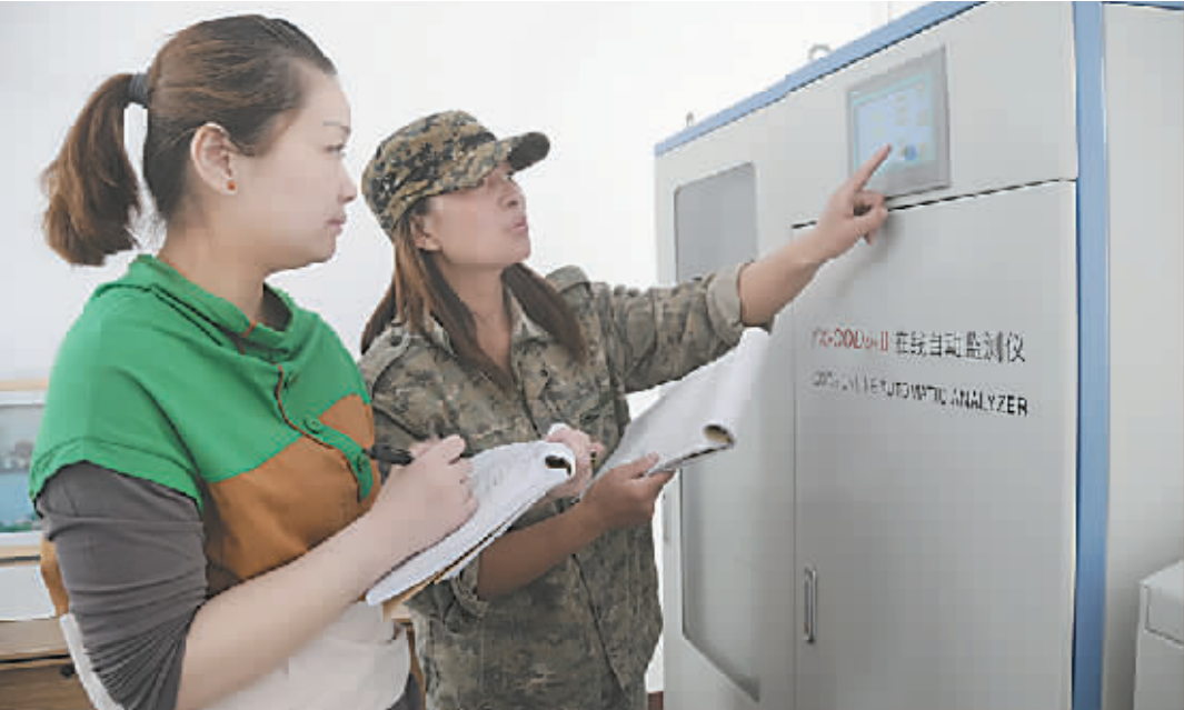
中马村矿新建的 YX—COD 污水处理系统，月净化矿井水达 269.6 万吨，提高了矿井水的净化排放标准，处理后的矿井水分别供焦作市第五水厂、地面生产、绿化和喷淋降尘、渔业等综合利用。图为 5 月 24 日该矿节能减排小组工作人员在污水处理站记录检测数据。
