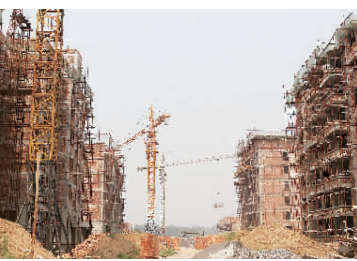
7月16日,西陶镇西渭封新型农村社区中心建设现场,塔吊林立,工人们正在紧张施工。该社区总投资5亿元,建设32栋住宅楼,建成后容纳1.5万人居住。目前,已开工建设24栋住宅楼,其中8栋已经封顶。
