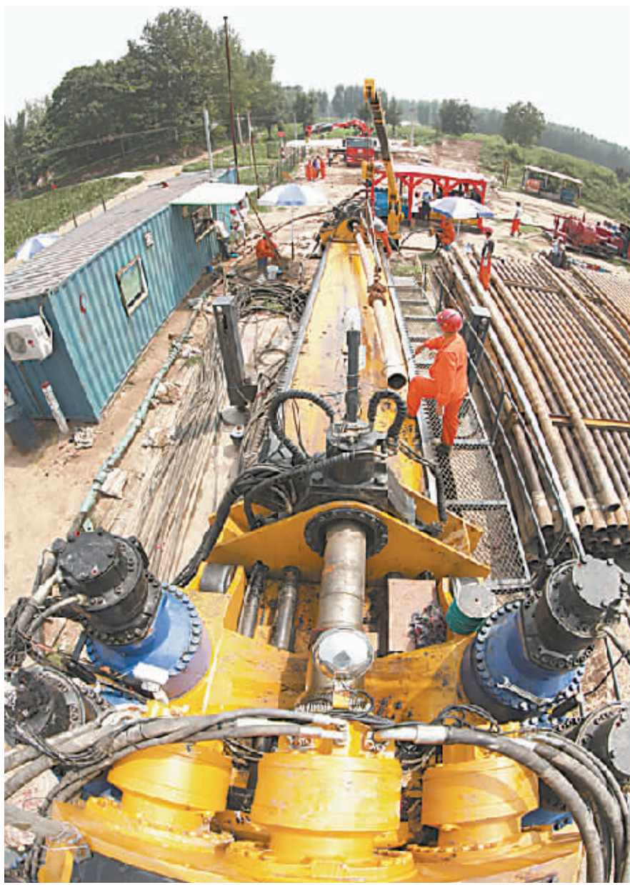
昨日14时，沁北引黄灌区工程正式开钻，建设者们沁北干渠施工I标段利用1000吨水平定向钻机进行引黄穿越倒虹吸压力管道定向施工。本报记者 赵耀东 摄
