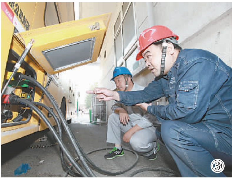
图① 检查体育馆地下室设备运行状况。 图② 开幕式现场外,保电员工坚守岗位。 图③ 检查应急电源车出线连接点。
