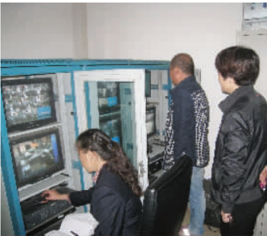
为进一步做好年末安全保卫工作，近期，工行焦作分行组织人员深入辖区各网点开展安全保卫工作检查。图为该分行工作人员正在检查监控设备运行情况。
