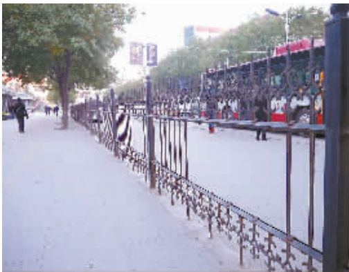
我市部分道路人行道边沿或过街天桥周边建有黑色铁栅栏,记者走访发现部分铁栅栏损毁严重。市容秩序监管中心相关负责人表示,市政设施属于公共财物不能随意破坏,希望市民能够爱护市政设施,如果发现有人破坏市政设施,可以拨打举报电话(0391)2607161。图为解放路纪念塔往西路北人行道边沿被损毁的铁栅栏。
