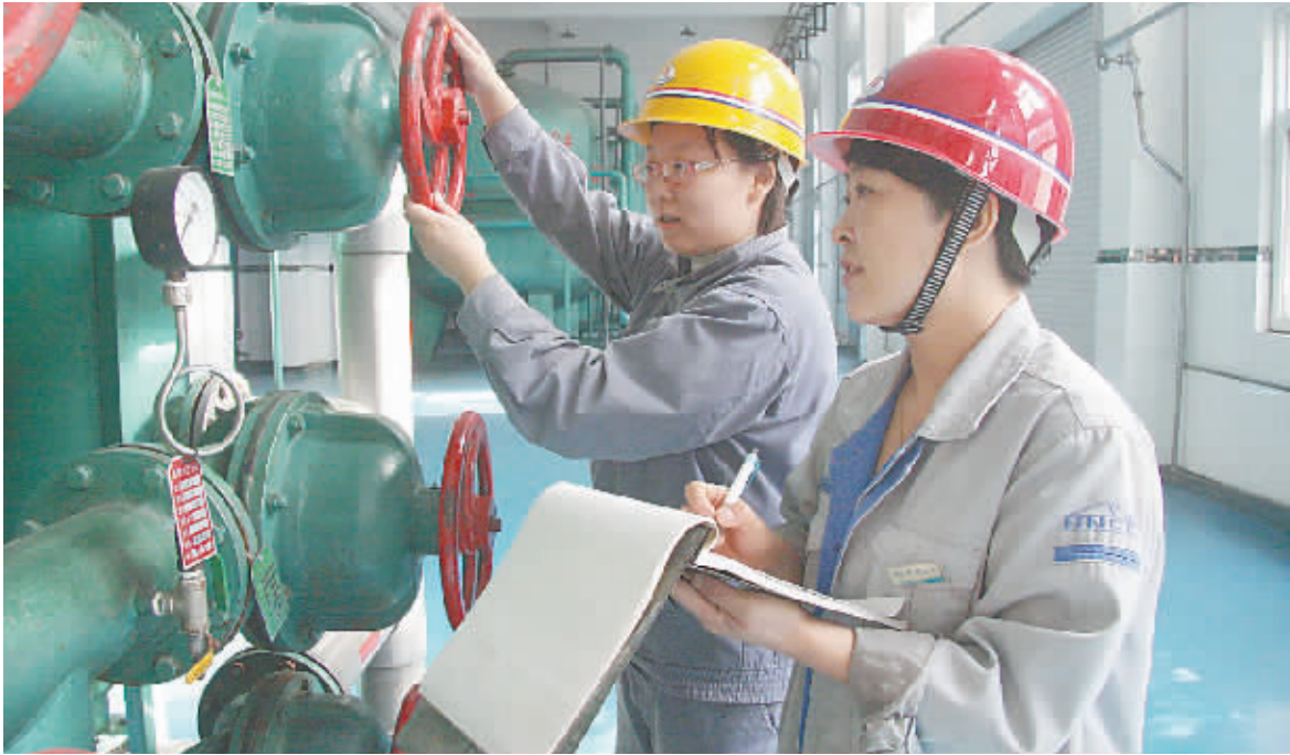
近日,电冶公司对影响生产运行的重要设备加大巡视检查力度,确保机组稳定运行,为全年各项任务指标顺利完成提供保证。
