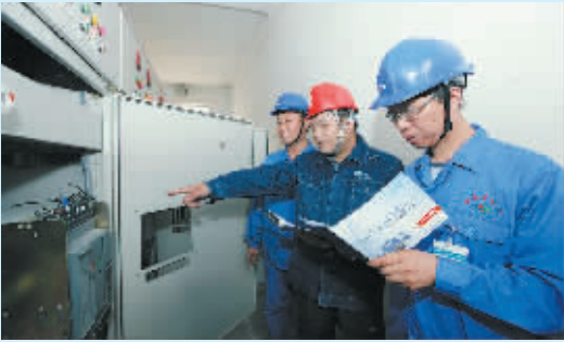
焦作供电公司电费管理中心工作人员到多氟多化工股份有限公司排查安全隐患。
