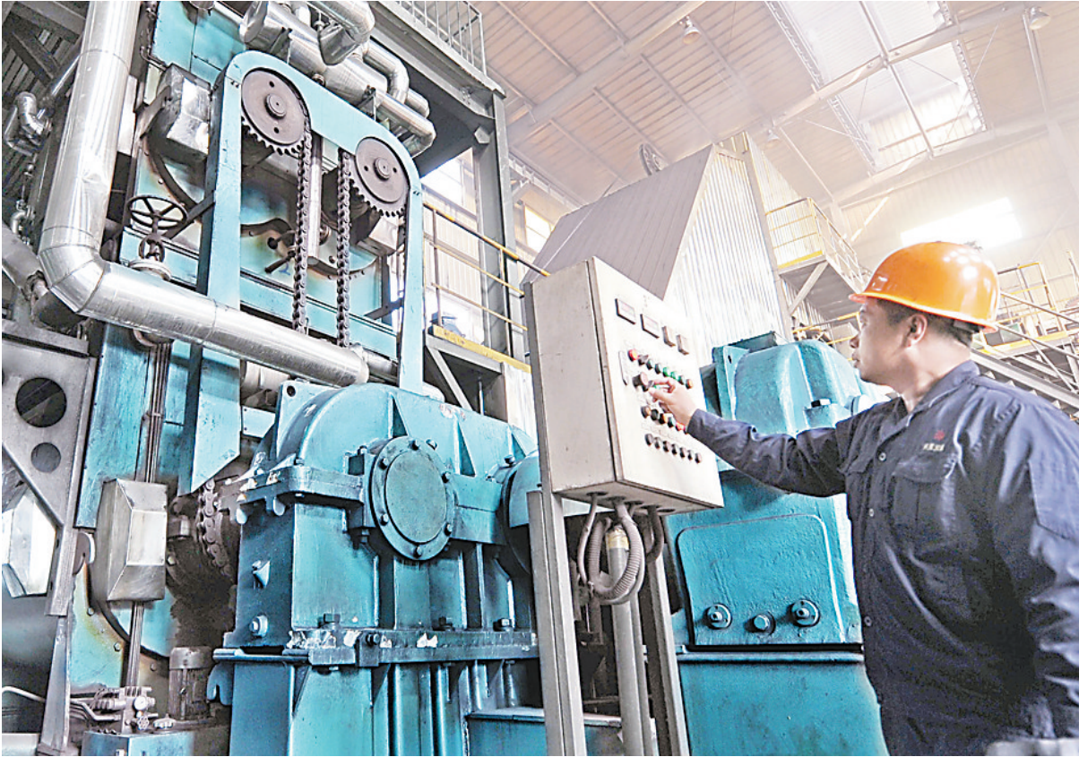
11月24日，焦作市英利经贸有限公司员工正在设备旁进行操作。该公司是一家主要生产经营铝电解用预焙阳极炭块的企业，今年3月份投资1500万元建设的预焙阳极生坯生产线开始试运行后，在人手不增加的情况下，劳动效率提升了3倍。
