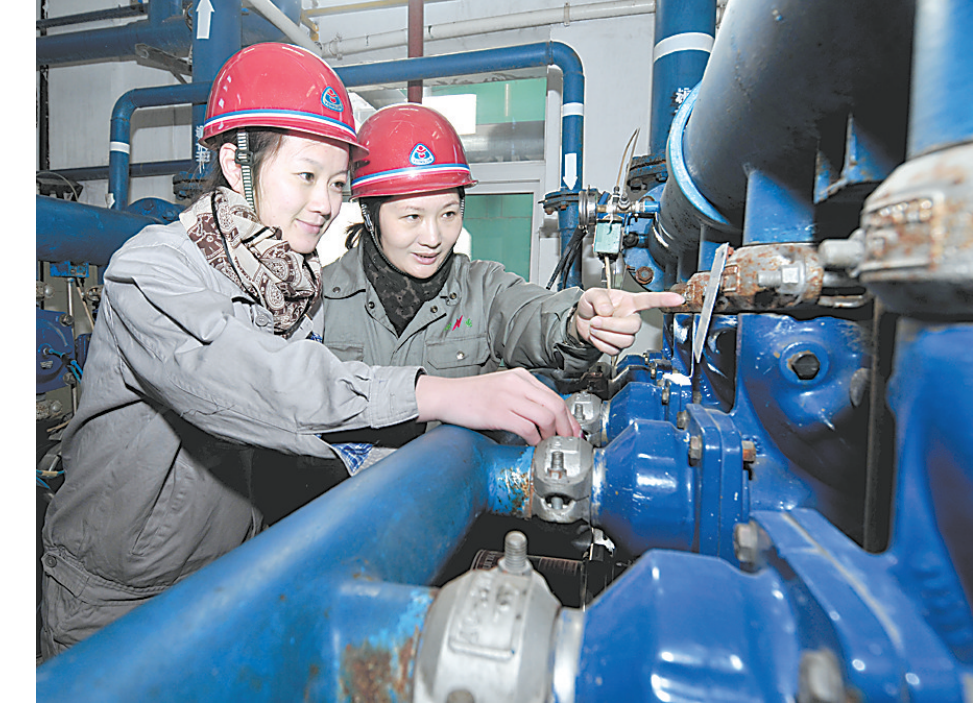
冯营电厂女工委以贯彻实施新《安全生产法》为契机, 结合女工岗位实际, 积极开展安全大检查、跑冒滴漏排查等安全活动, 确保年末安全生产运行。图为12月17日该厂女工在水处理间检查盘滤设备运行情况。王海成 摄
