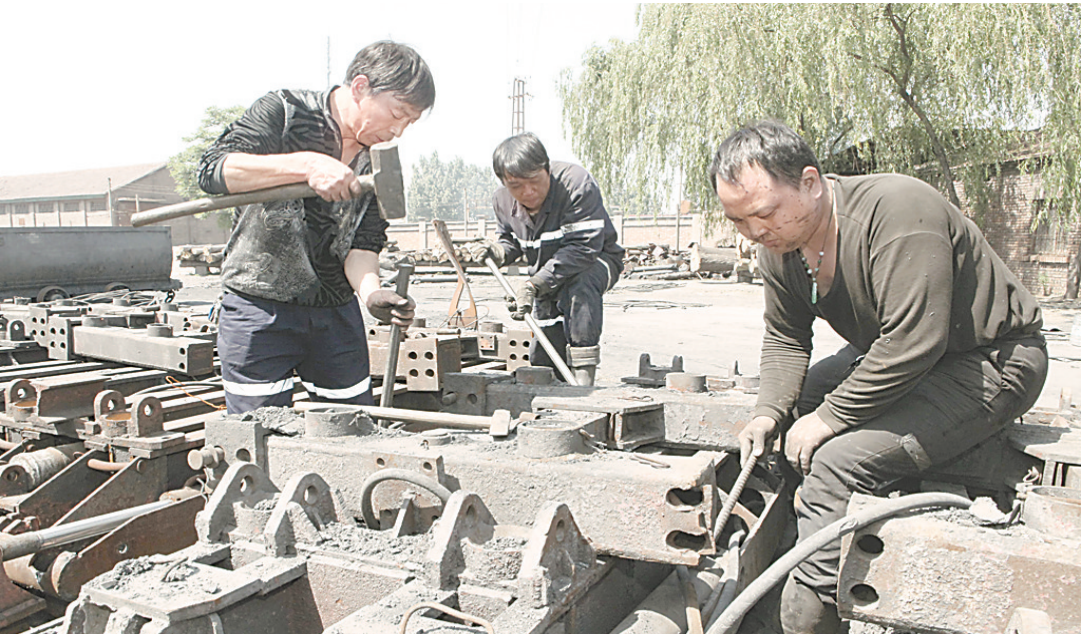
6月5日，焦煤集团鑫珠春公司职工正在对悬移支架进行检查维护。为确保安全生产月期间井下的安全生产，该公司加大一线机电设备、机组设施安全的检查力度，专门成立了机电、气动等6个专业组，对设备逐一进行检查维护。
