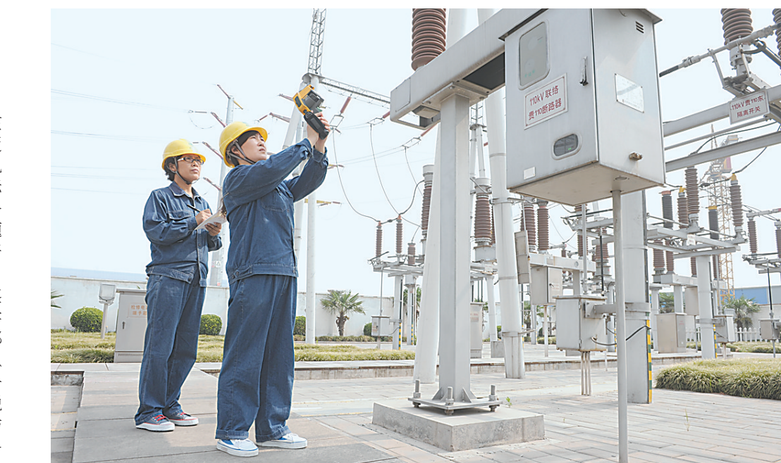
7月10日，博爱县供电公司技术人员正在110千伏变电站对变电设备进行测温。连日来，气温持续走高，用电负荷急剧攀升，为了确保设备安全稳定运行，该公司加大对变电设备的巡视维护力度，确保设备始终运行在健康稳定的状态。程刚 摄
