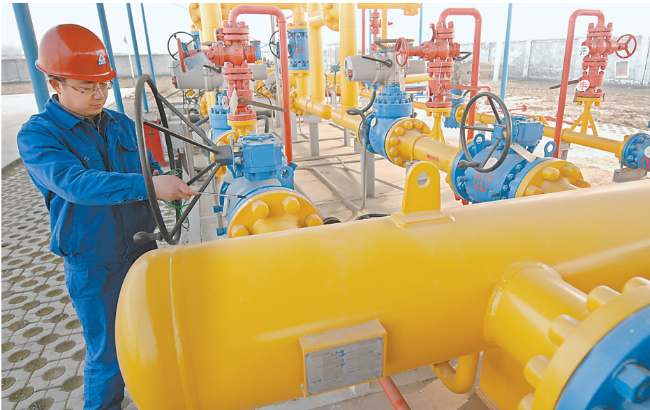
修武中裕燃气发展有限公司员工正在对设备进行巡检。
