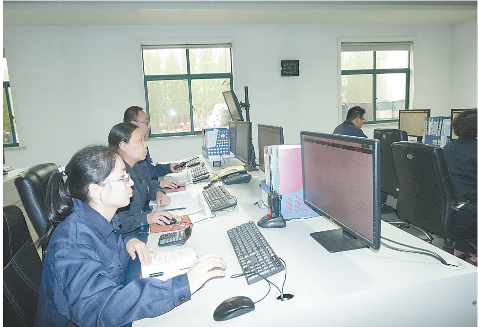
自新厂投入使用以来，博爱新开源制药股份有限公司紧紧围绕科技创新，生产设备已全部实现自动化、智能化生产，整个厂区均建立了DCS控制平台，不仅提高了工作效率，而且生产中的各项数据也能及时准确进行反馈。图为该公司操作工正在DCS总控室
