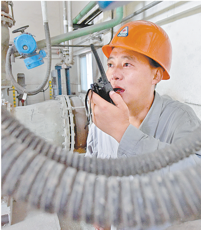
为迎接党的十九大胜利召开，冯营电厂对重点设备、重要设施以及薄弱环节等进行全天24小时监控，确保发电机组安全运行。图为该厂职工昨日在锅炉超低排放现场用对讲机报告设备运行情况。
